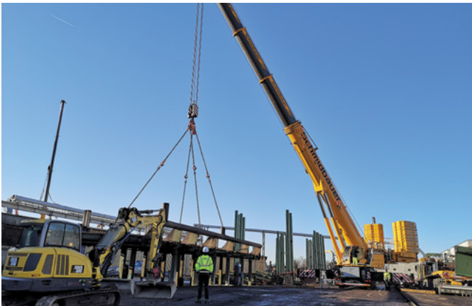
Bei der Schwaiger Holzindustrie wickelte SGS Industrial Services die mechanische Montage des Rundholzplatzes ab
