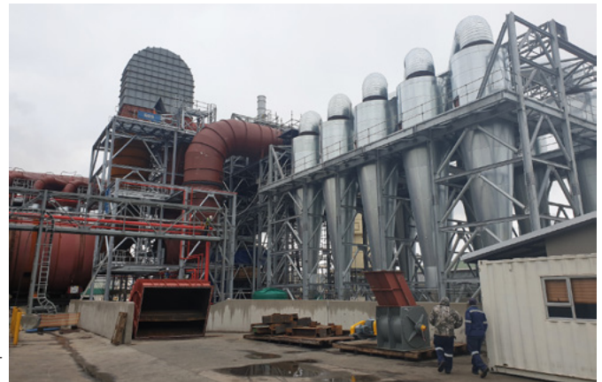
Bei PG Bison in Südafrika führte SGS die Montage einer Trocknungsanlage für die Spanplattenproduktion durch
